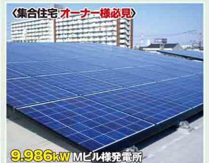
9.986kW Mビル様発電所
