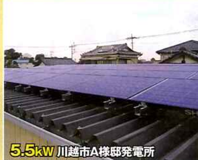
5.5kW 川越市A様邸発電所
